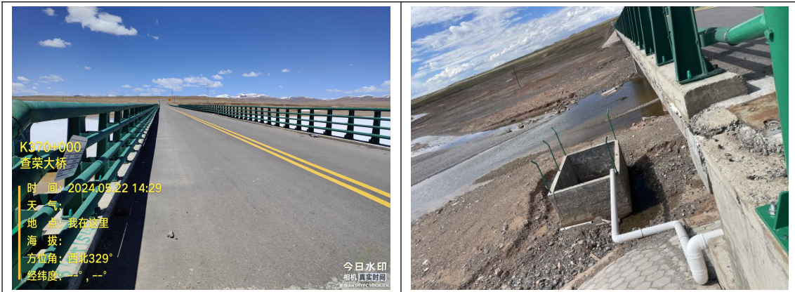
K370+090 查荣大桥：桥面径流+收集池（18m 3 ）
