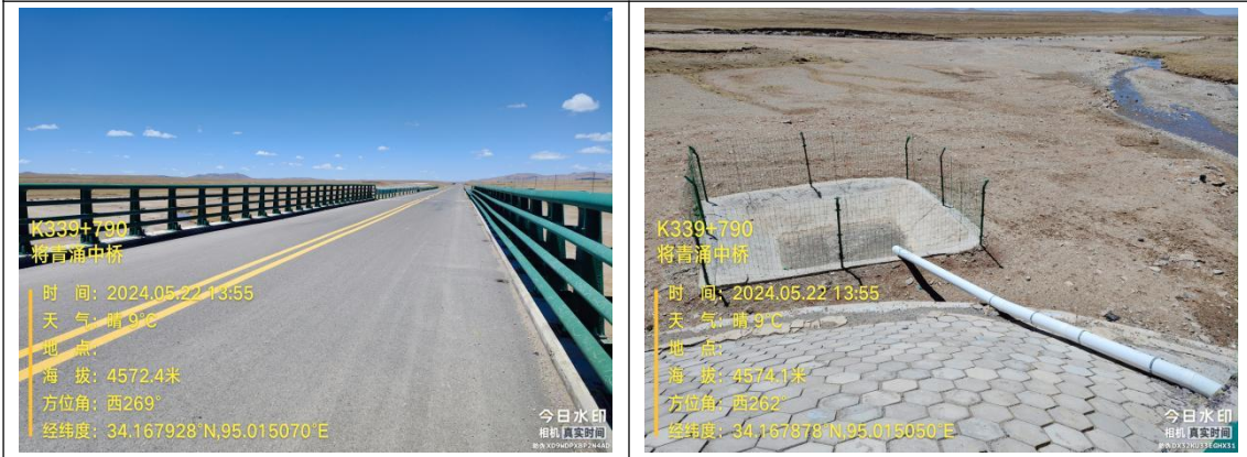
K339+624 将青涌中桥：桥面径流+收集池（18m 3 ）
