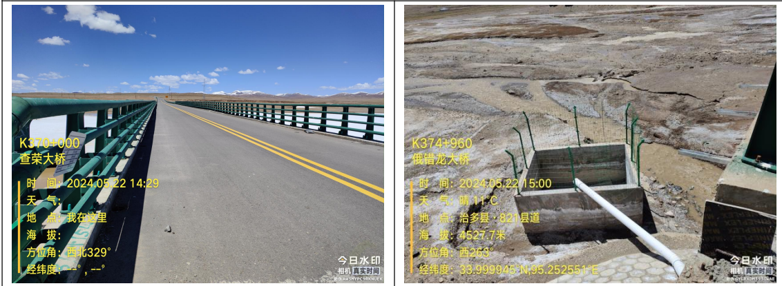
K374+960 俄错龙大桥：桥面径流+收集池（18m 3 ）
