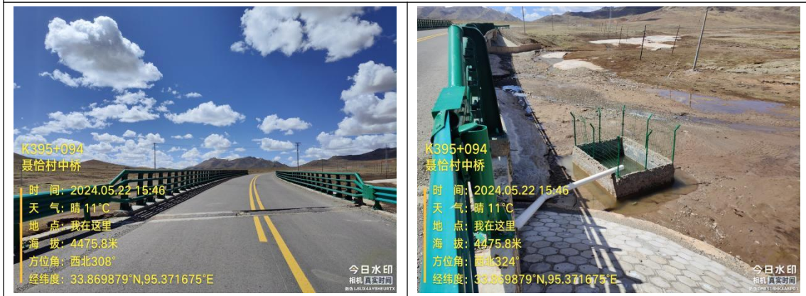
K395+094 聂恰村中桥：桥面径流+收集池（18m 3 ）
