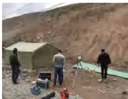
k116+700 施工 4 标沥青拌合站
